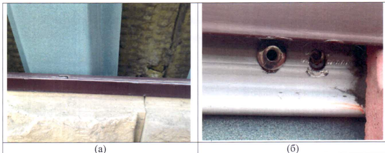
Рис. 2. Внешний вид профиля ПФК в составе навесной фасадной конструкции: а – с повреждениями полимерного слоя, б – область заклепочного соединения
